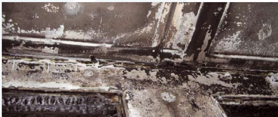
Eftervirkningerne af kraftig brandpåvirkning af beton omkring vinduesudsparring.
