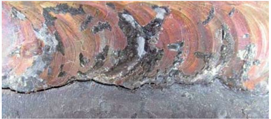
Figur 1: Svejst beslag med revner langs svejsningen.
