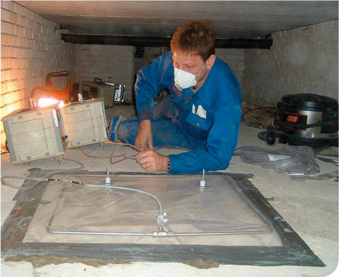
Foto: Måling av inntrengning av perchlorethylen fra forurenset jord under gulvet i en krypkjeller.
