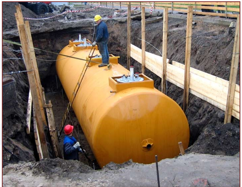
FORCE Technology rådgiver om den korrekte overfladebehandling af nedgravede tanke for at hindre rustdannelse.
