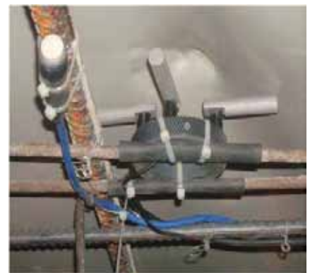
Figur 3: Typisk installation af en CorroWatch-sensor og en ERE 20-referenceelektrode
